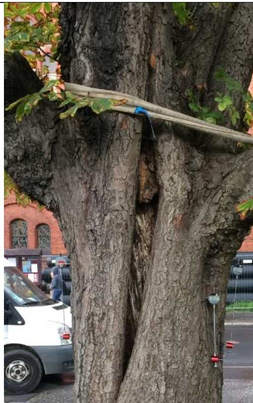
Fot. 5-4 Kasztanowiec 5, Pl. Kościeleckich, Bydgoszcz. Ubytek otwarty wzdłużny na pniu.
