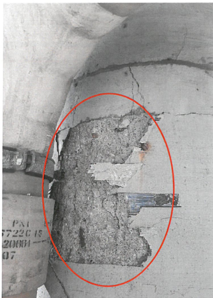
Rys. 8 Uszkodzone mata z włókna węglowego wzmacniająca słup. Widoczny odstąpiły skorodowany powierzchniowo i spękany beton. Można domniemywać, że podobny jest stan betonu wszystkich słupów pod płaszczem z maty włókna węglowego. Jest to tym bardziej prawdopodobne, że ostukiwanie płaszcza wskazuje, że nie wszędzie jest on skutecznie przyklejony do podłoża (podpora 6 Pd)
