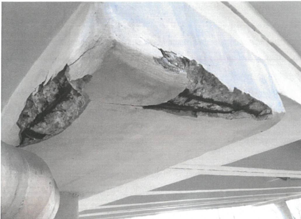
Rys. 20 Ubytki otuliny i korozja odsłoniętego zbrojenia elementu uciągającego przęsła (oczep, podpora 7 Pd)
