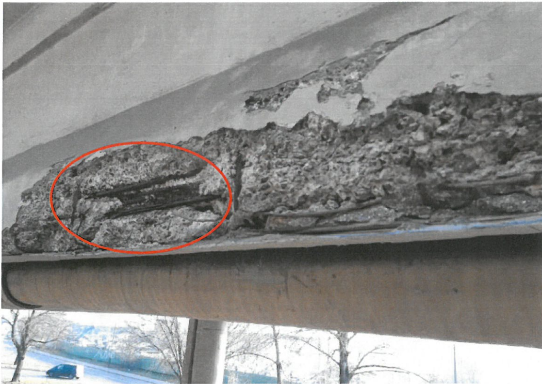
Rys. 15 Ubytki betonu dźwigara głównego. Odstłonięte skorodowane sploty (przęsło 4-5 Pd)
