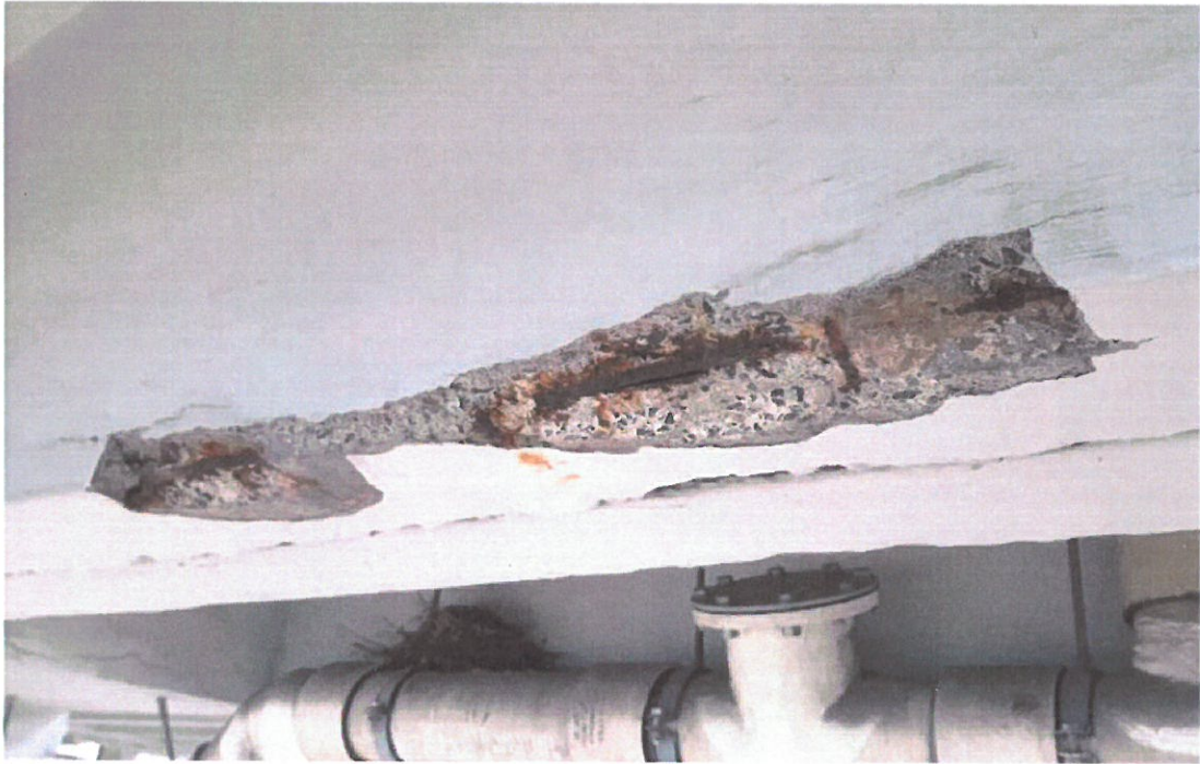
Rys. 13 Ubytek betonu na krawędzi belki sprężonej. Odślonięte, korodujące zbrojenie (Przęsło 6-7 Pd)
