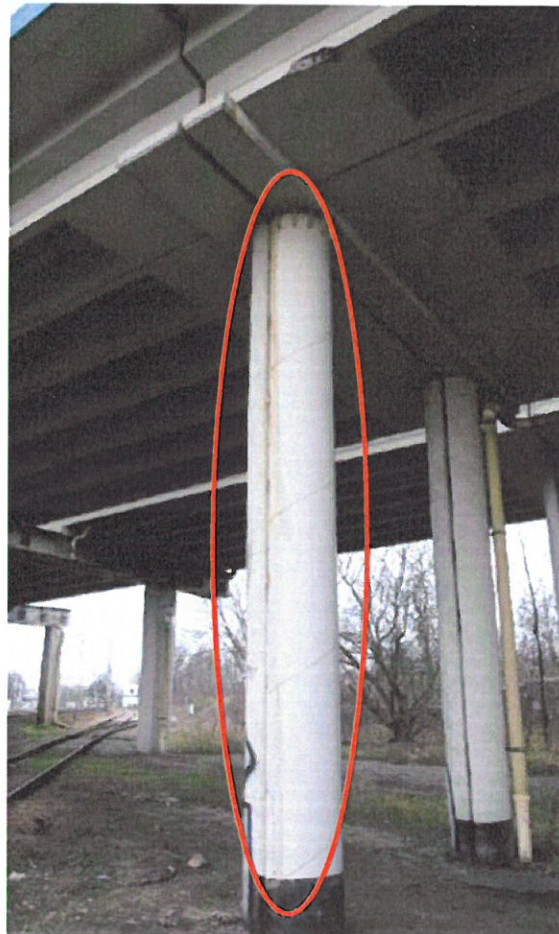
Rys. 7 Płaszcz stalowy na słupie podpory dwudzielnej (podpora 14 Pd). Widoczne rdzawe zacieki.
