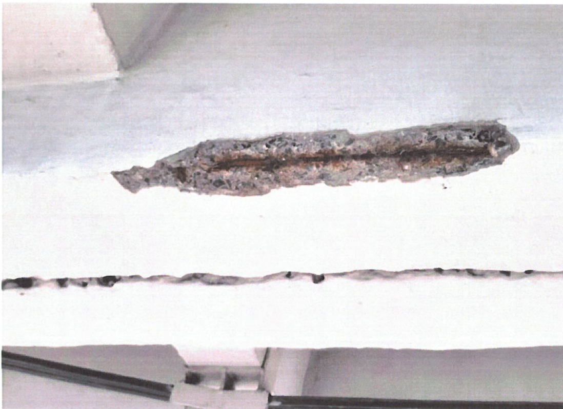
Rys. 14 Ubytek betonu na krawędzi belki sprężonej. Odślonięte, korodujące zbrojenie (Przęsło 5-6 Pd)
